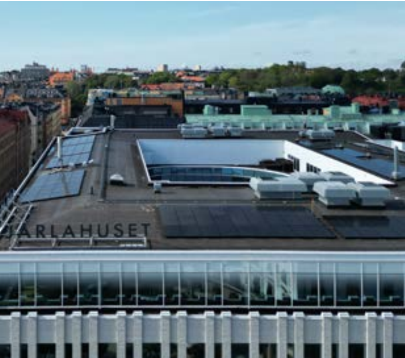
Utökad solcellsanläggning Jarlahuset 2025.
